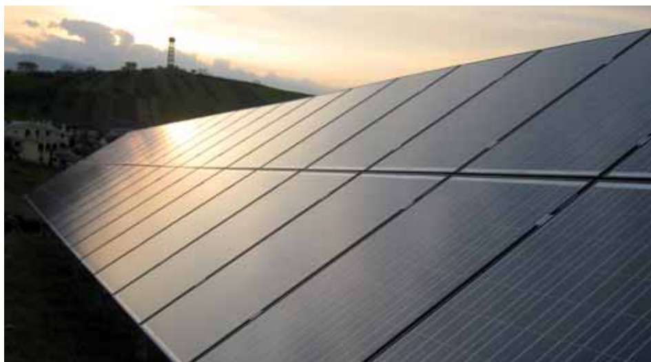
■ Esempio di impianto Bienergy da 20 kWp realizzato a Sant'Egidio alla Vibrata (Teramo)
